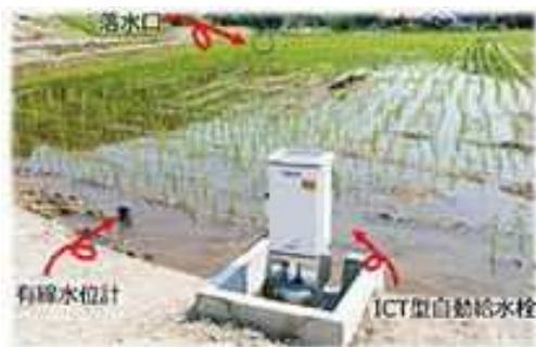
ICT型自動給水栓の設置状況
