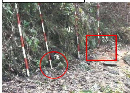
堤体下流側の漏水状況
