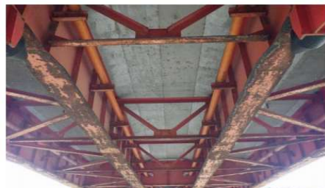
【主桁・横桁の腐食状況】
