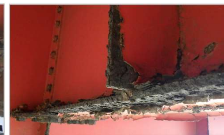
【横桁の腐食状況】
