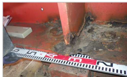
【主桁の腐食状況】
