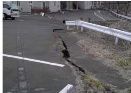
(b)のり肩の亀裂
