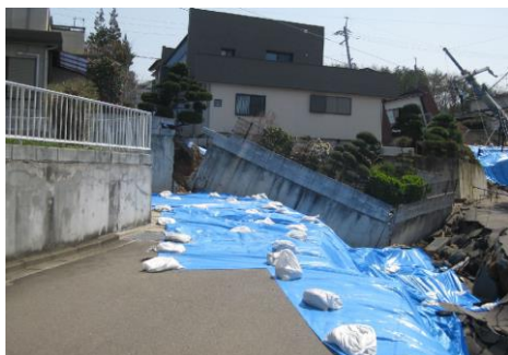
(c)腹付け盛土の崩壊
