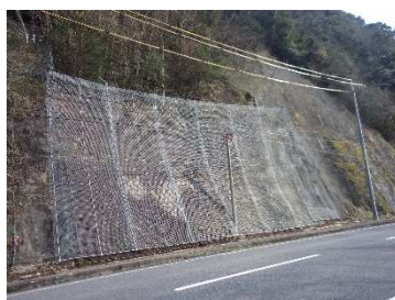
落石防護網 国道187号 (津和野町)
