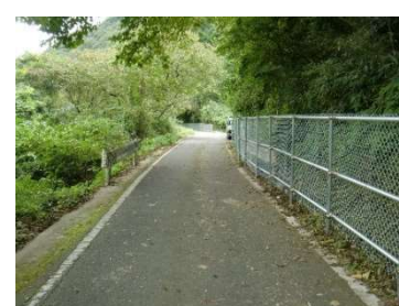
簡易単管防護柵 (一) 邑南美郷線 (邑南町)
