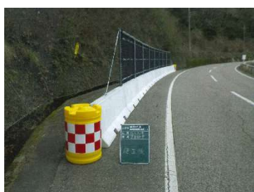
簡易防護柵 国道488号 (益田市)
