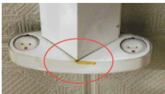
蛍光灯安定器の劣化により P C B 油が漏れ出した例（環境省HP資料より）
