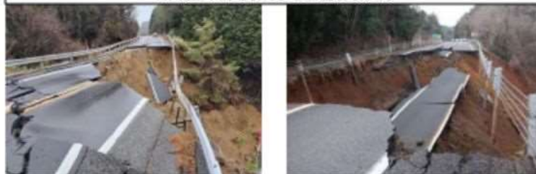
R6能登半島地震による盛土崩壊状況
