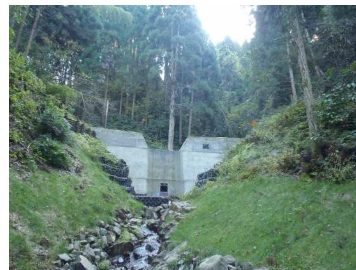
[土砂流出防備保安林] 谷止工
