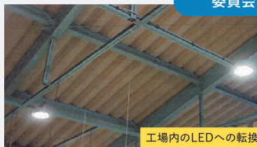
工場内のLEDへの転換
