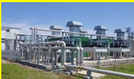
発電施設 【東部浄化センター】
