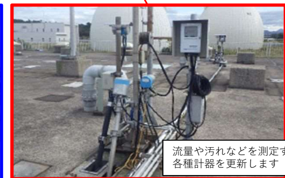
【水処理計装設備（西部浄化センター）】
