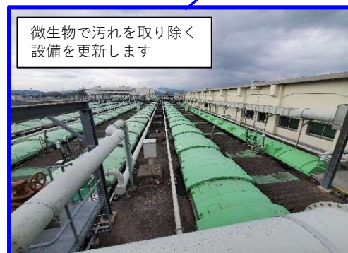
【生物反応槽（東部浄化センター）】
