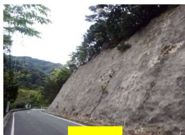
道路の落石対策
