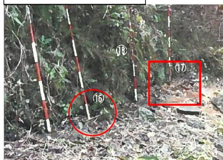
堤体下流側の漏水状況
