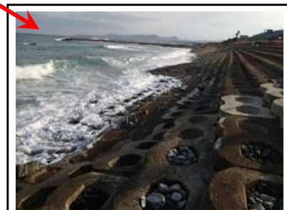
損傷状況 (R5年2月)
