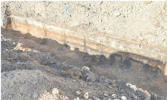
型枠の杭痕跡
