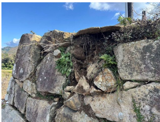
国史跡富田城跡 石垣被害状況
