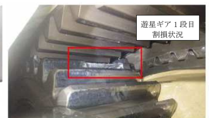
（ギア損傷状況）
