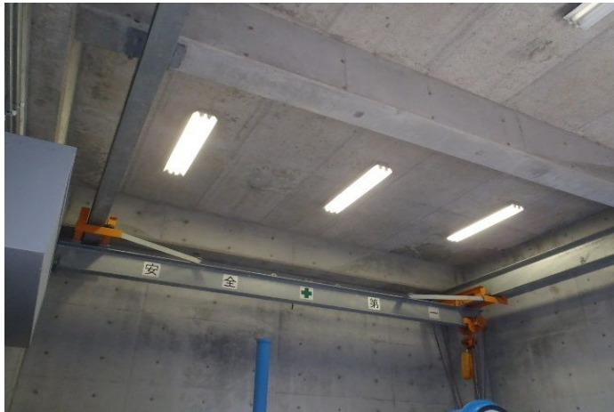
天井クレーン
