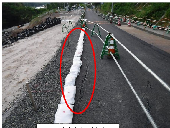
ひび割れ状況
