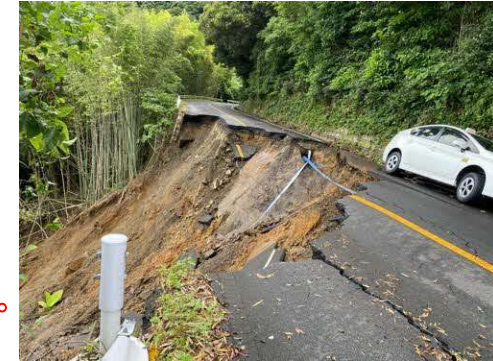
被災状況写真(R6.7.10 9:00ごろ撮影)
