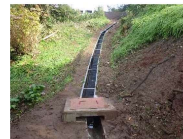
地表水排除工 (表面水の地下浸透を防ぐ：排水路)
