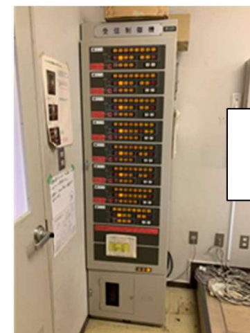
受信制御器 (合同庁舎内)
