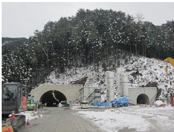
島根県側坑口は雪景色。約5kmの長大トンネルのため、本坑の横には並行して避難坑が設けてあります。
