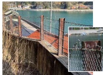
補修前（網破損、錆）
