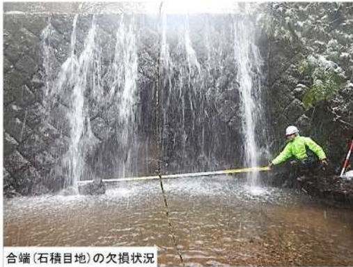
合端(石積目地)の欠損状況
