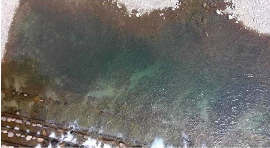
【溪流保全工の下流部洗堀状況(垂直撮影例、ただし洗堀深さは把握できない)】
