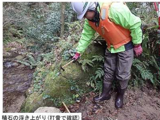
積石の浮き上がり(打音で確認)
