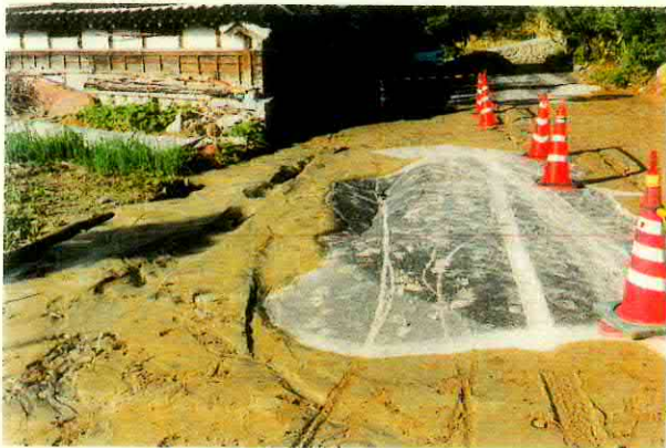
液状化した市道（安来市）
