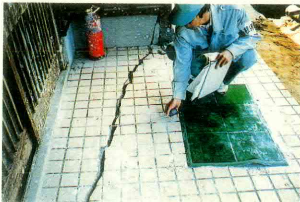
玄関に亀裂の入った家屋（能義郡伯太町）
