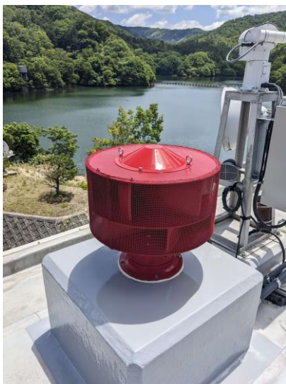
警報用サイレン
