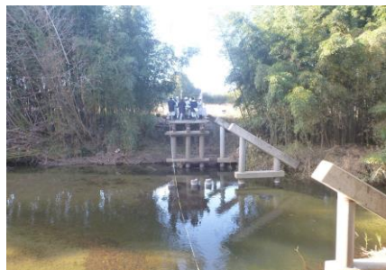
篠山橋(査定状況)
