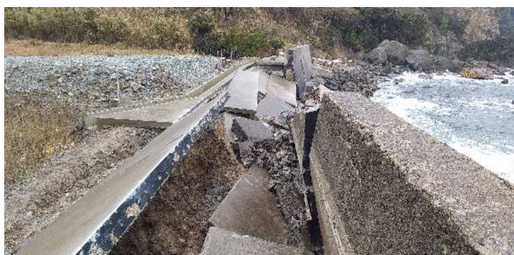
写真-1.4 被害状況
