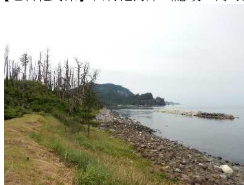
【老朽化対策】西村港海岸（隠岐の島町）
