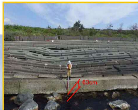
② 先端方塊下部の空洞最大(63cm)箇所(No.1+8.15)
