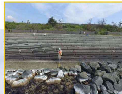
③ 先端方塊下部の空洞発生起点(No.0+4.2)
