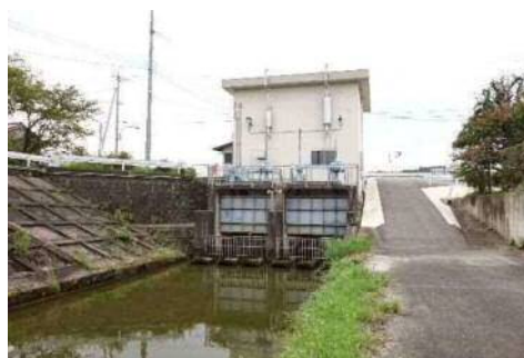
内原川排水機場
