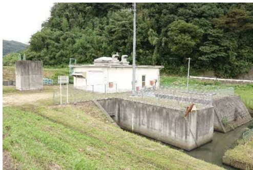
堂の前川排水機場
