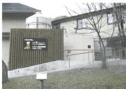
木質ペレット焚ボイラー
