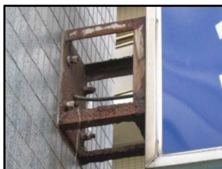
サビによるブラケットの腐食
