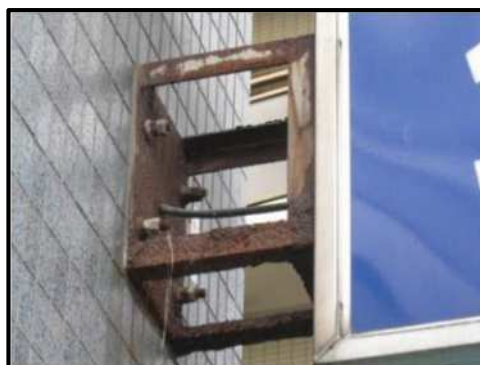
サビによるブラケットの腐食
