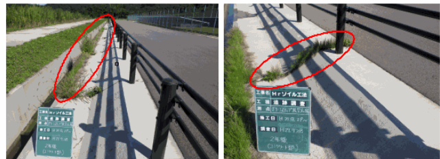
水路との境界に雑草侵入
