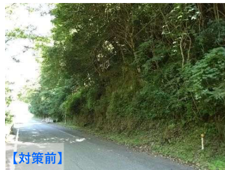
落石防護網 (浜田美都線 弥栄地区)
