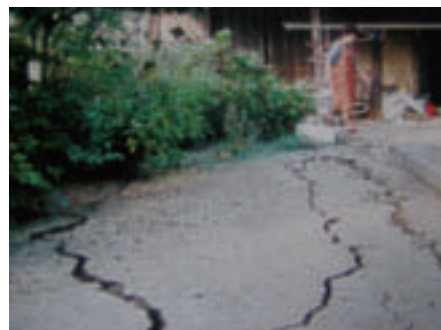
地震による地割れ (平成12年、安来市伯太町)
