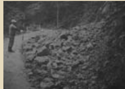
切り取り斜面の崩壊（飯南町）
