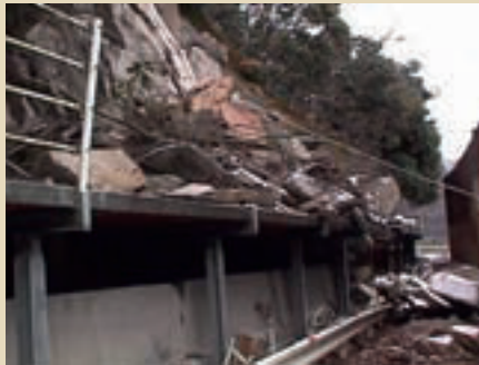
道路周辺の崩壊（日野町）
