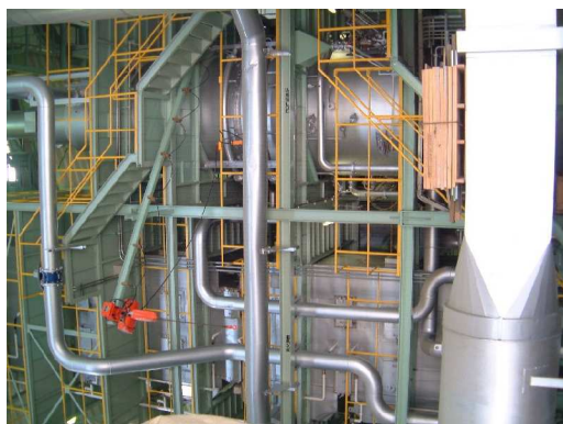
RDF 燃焼設備
