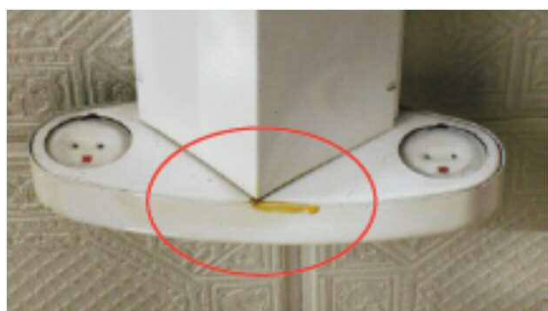
蛍光灯安定器の劣化により P C B 油が漏れ出した例（環境省HP資料より）
