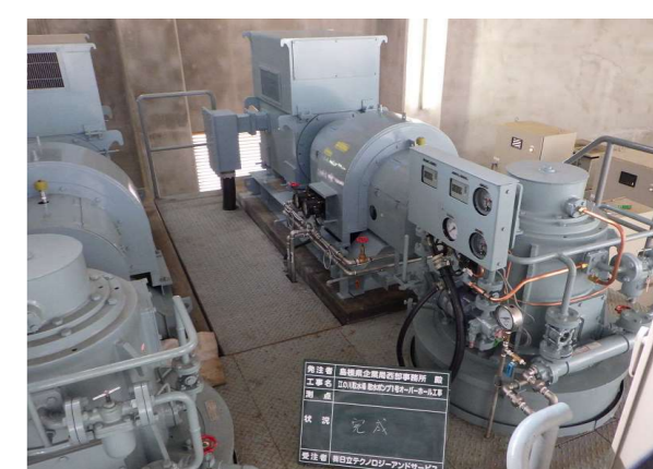
西部事務所(江津浄水場)取水ポンプ
