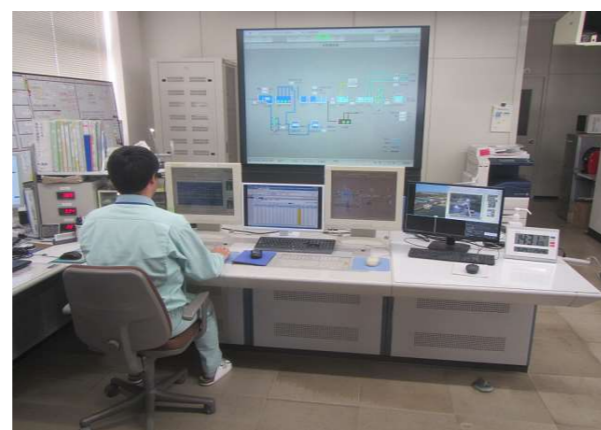
東部事務所運転監視制御卓
