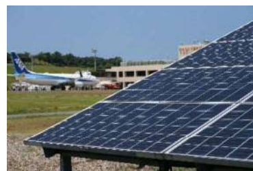
石見空港太陽光発電所（太陽光）
