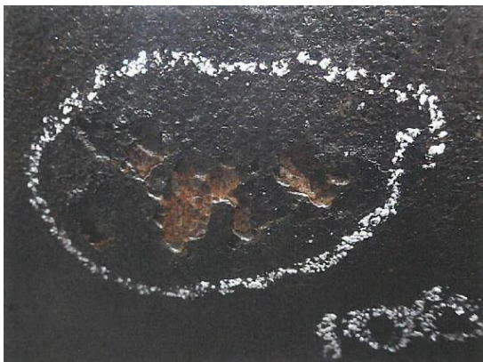
[管体の腐食状況]
