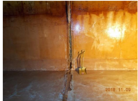
[伸縮継目部の老朽化]
