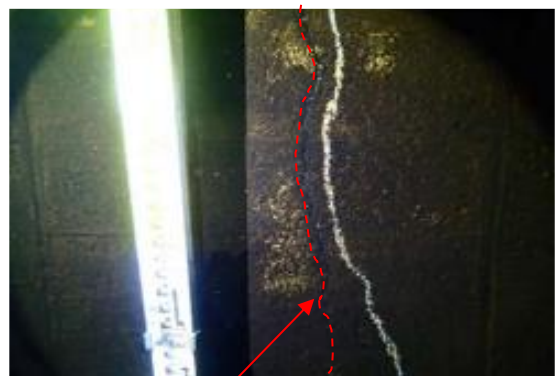
[内部壁のひび割れ 1～3mm]
