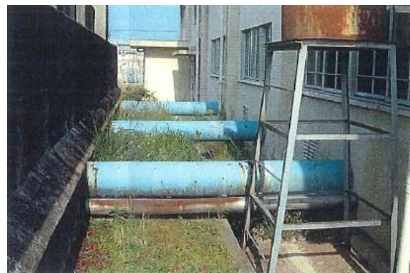
今津浄水場沈砂池～送水ポンプ室への配管
