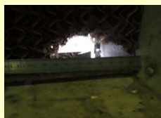
Butas sa dingding ng manukan
