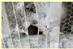
鶏舎金網の破損
