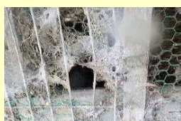
鸡舍围栏网破损
