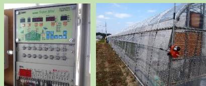
【ハウス内環境制御装置】
