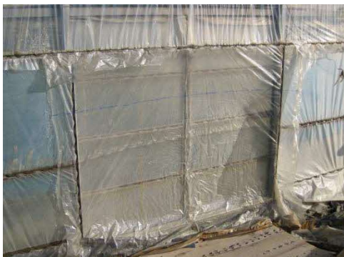
使用しない出入口を目張り
