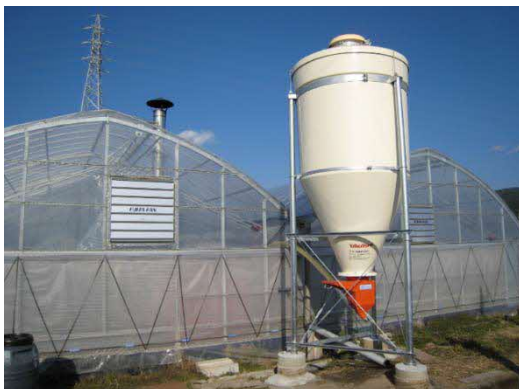
貯蔵タンクの設置スペース
