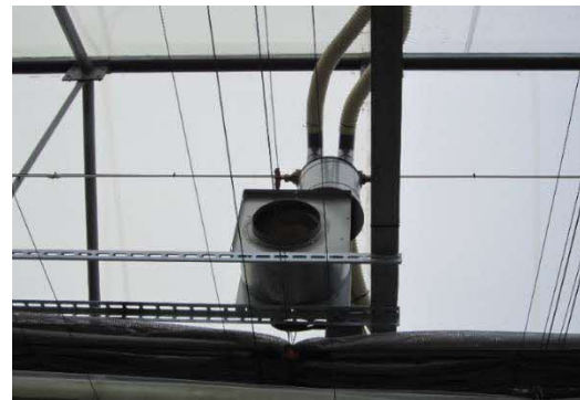
空気膜の加圧のための送風ファン
