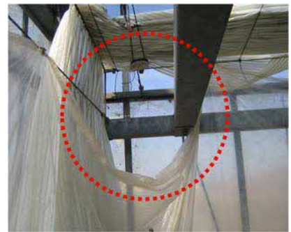
温室のコーナー部の隙間
