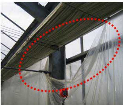
肩部の垂れ下がりによる隙間
