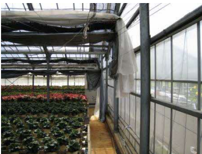
妻面のカーテンの隙間
