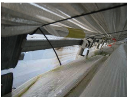
多層カーテン肩部の隙間
