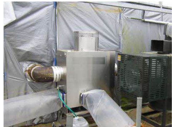
排熱回収装置
