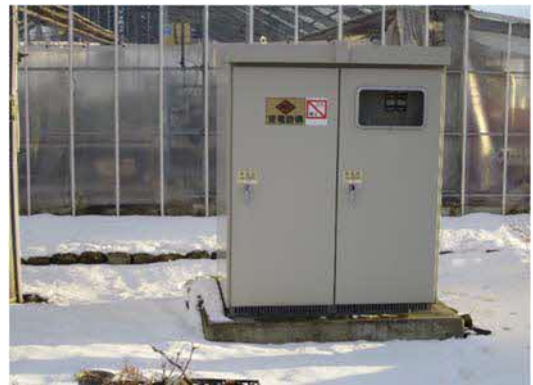
高圧受電設備（キュービクル）
