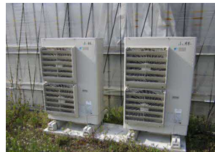
風向ガイドを取り付けた室外機
