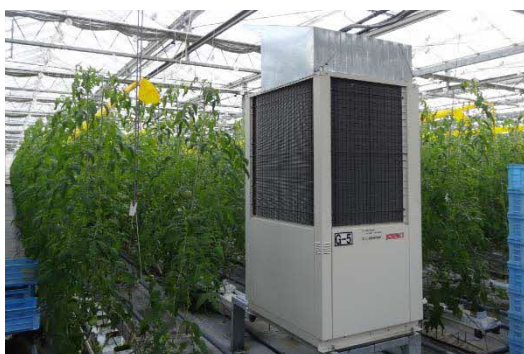
地下水熱源ヒートポンプ（室内機）
