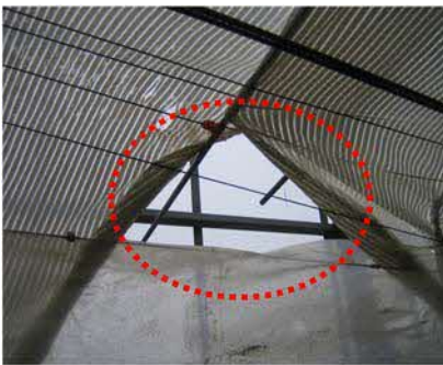
天井カーテンの隙間（妻面）
