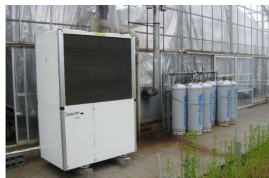
ガスヒートポンプ（室外機）
