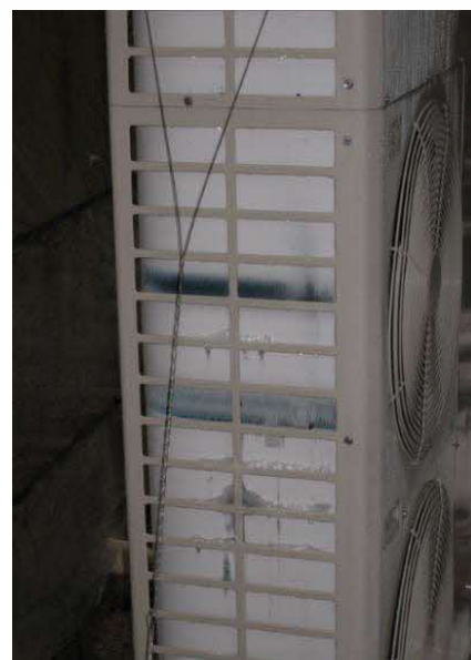
霜が付着した室外機
