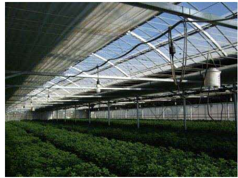
内張カーテンの自動開閉
