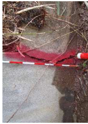
余水吐側壁の老朽化状況
