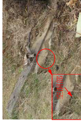
取水施設(斜樋)の老朽化状況
