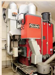
チップボイラー
