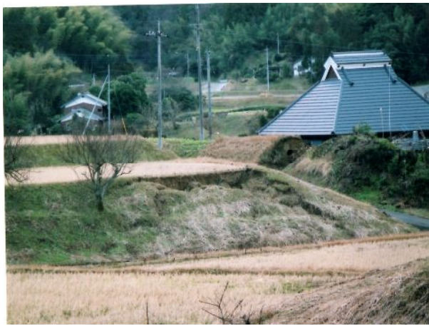
農地法面の崩壊状況
